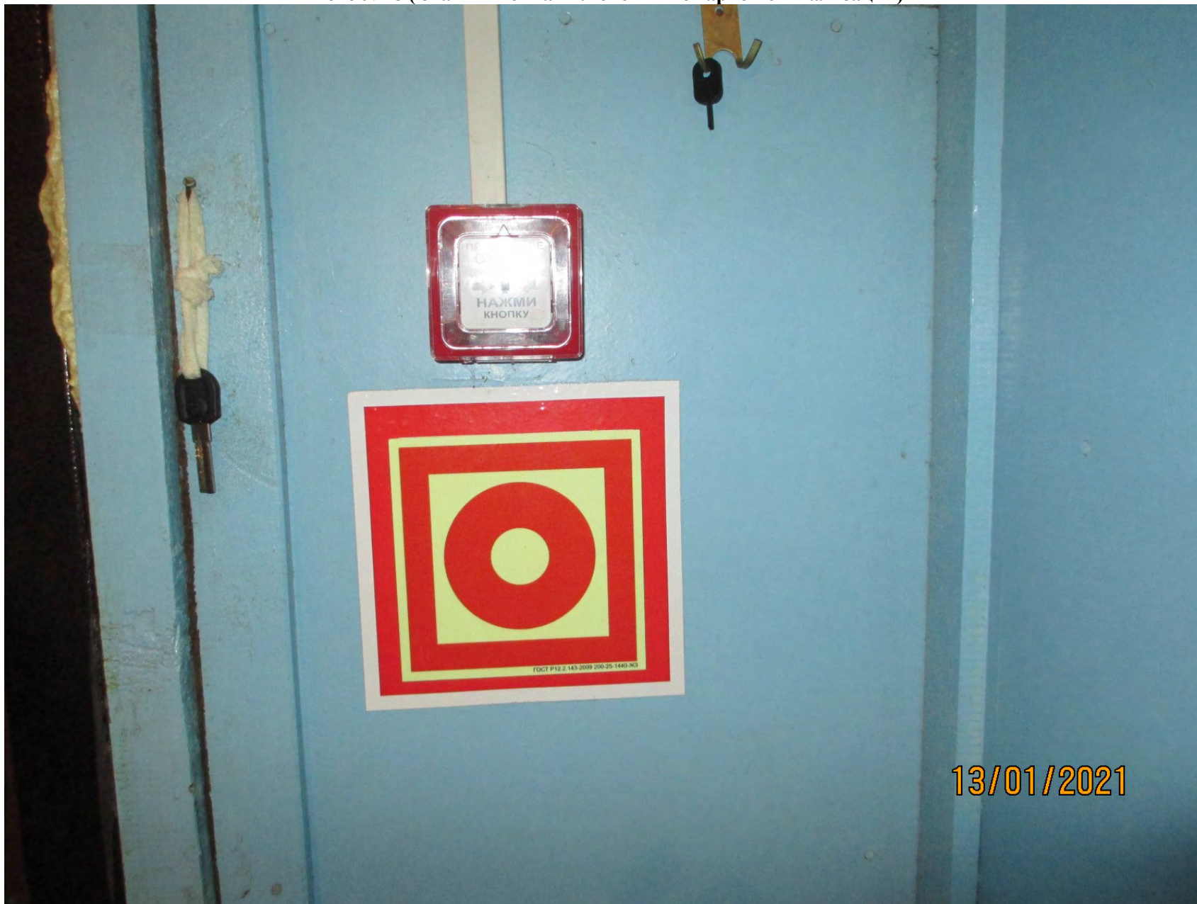
Фото №28 (знак и кнопка включения пожарной сигнализации)
